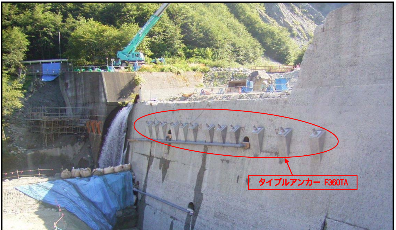
【小武川第四砂防えん堤】 施工中写真 (国土交通省 関東地方整備局 富士川砂防事務所)
